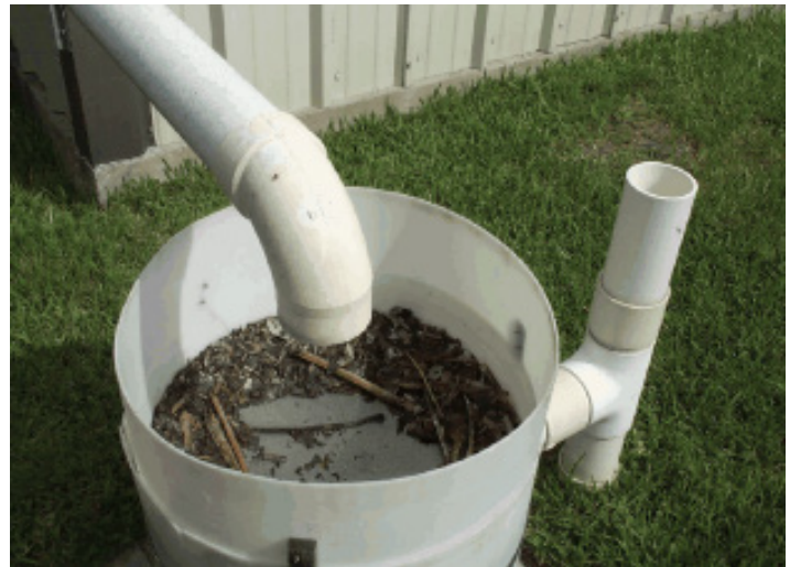
Figura 13. Tanque de prefiltro
