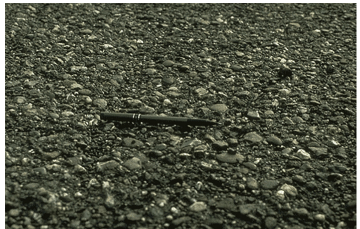
Figura 9: Desprendimiento de áridos de la mezcla asfáltica. Fuente: [30]
